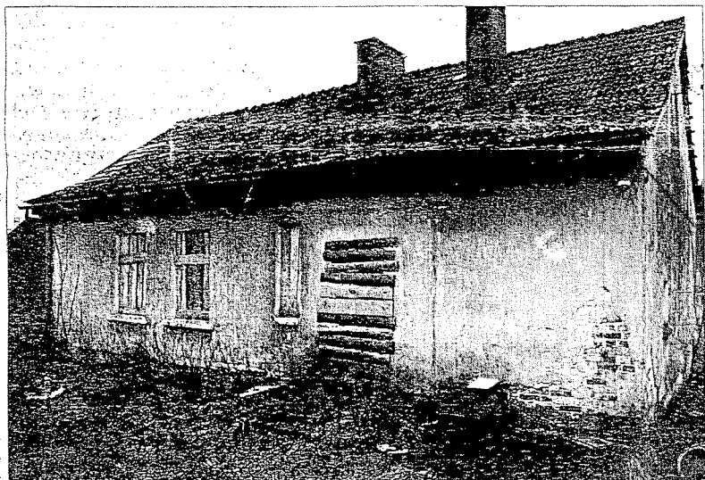
Na remont tego mieszkania w Wapnicy pieniędzy już zabrakło. Jeszcze niedawno mieszkali tu ludzie.
